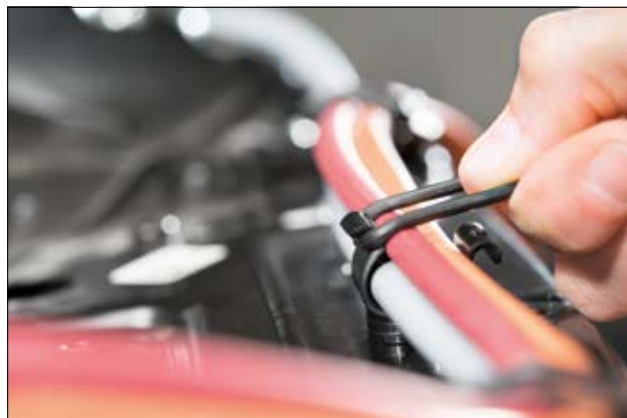
Cradle Clip to prosta i wszechstronna metoda wiązania kabli. Obejma składa się z dwóch elementów - uchwytu i elastycznej pętli napinającej.
