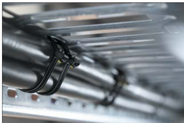
Opaski serii KR zastosowane w korytku kablowym.
